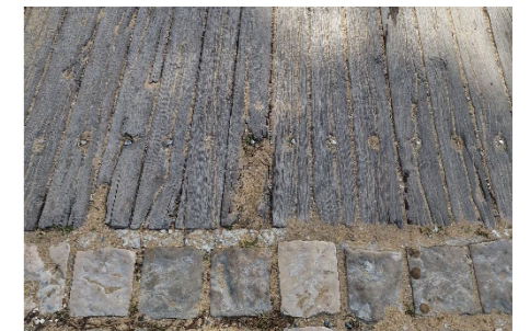
Platelage bois détérioré au niveau de la traversée piétonne
