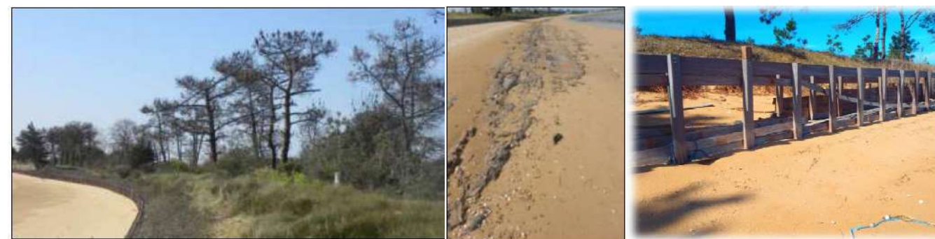
Figure 24 : Cordon dunaire entre Fort Royer et Bellevue (gauche) - Couche d'argile rendue visible suite à l'érosion (centre) - Destruction des palplanches en bois (droite) - Source : RNN Moëze-Oléron
