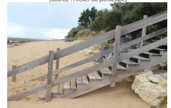
Escalier d'accès à la plage témoignant du recul du trait de côte (Source : Atelier du périscope)
