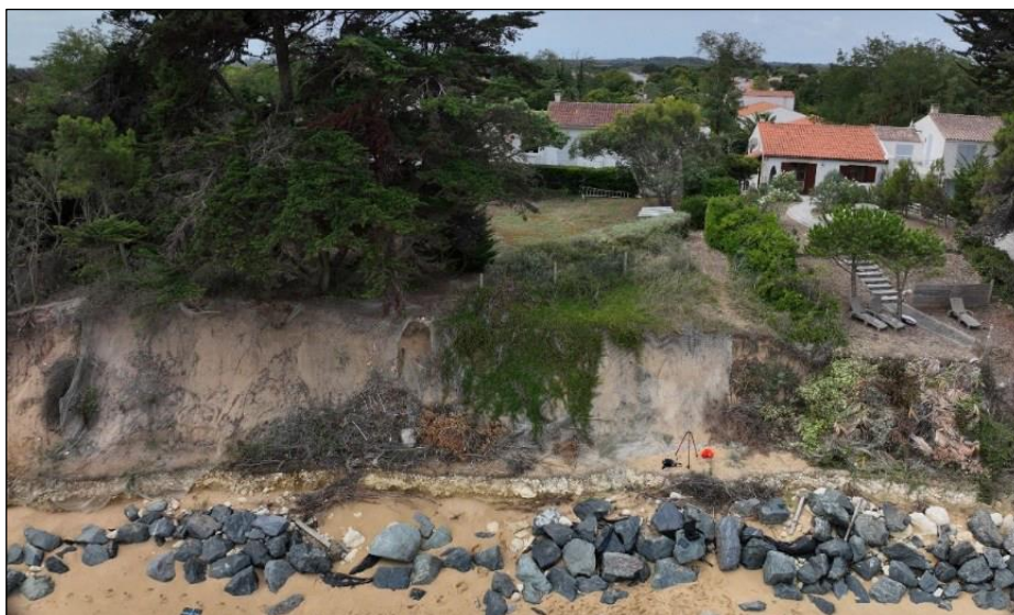
Figure 30 : Front d'érosion dunaire avec tentatives non concluantes de protection du cordon avec des branchages, et des filets sur ARA (Neoseastem, APS, 2026)
