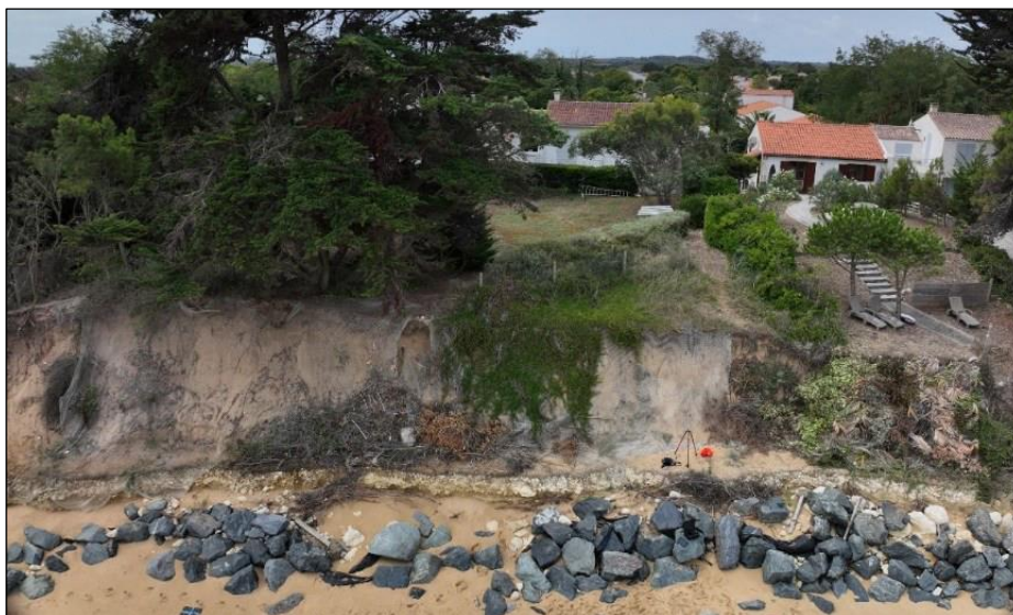
Figure 55 : Front d'érosion dunaire avec tentatives non concluantes de protection du cordon avec des branchages, et des filets sur ARA (Neoseastem, APS, 2026)
